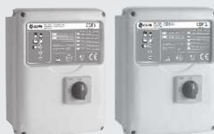
Шкафы управления CDF1, CDF2
